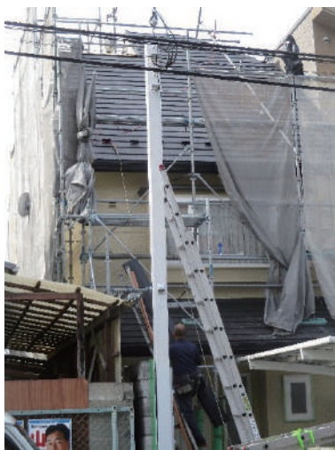
築後19年 弊社新築 メンテナンス修繕施工例 平成29年2月 M様邸
