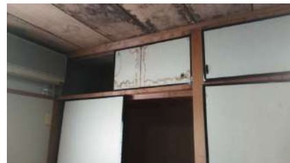
Before: 和室の天井、建具が、雨染みやカビで傷んでいます。
